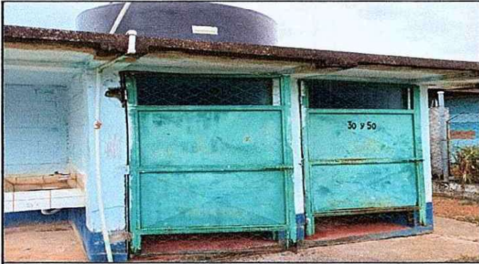
Foto 1: se observa las paredes del servicio sanitarios en mal estado.
