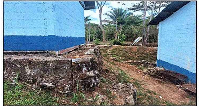
Foto 4: se observa la necesidad de un construir muro de contención entre cocina y aula.
