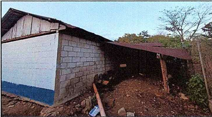
Foto 3: se observa el deterioro de la estructura en madera como también las láminas en mal estado de la cocina.
