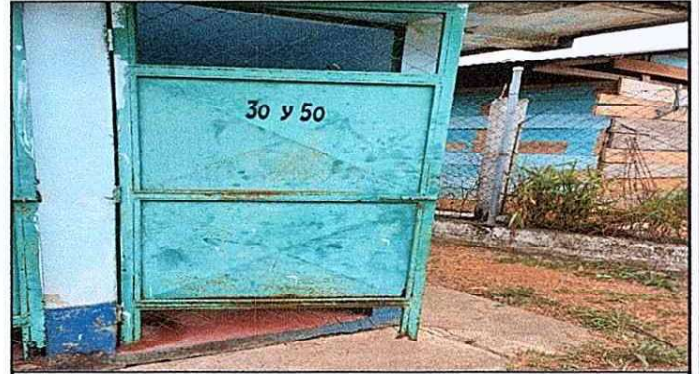
Foto 2: se observa el avance de la corrosión de las puertas metálicas.
